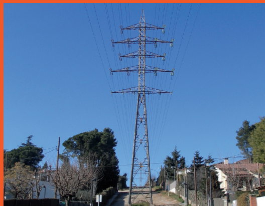
Torre elèctrica a l'avinguda del Baixador
